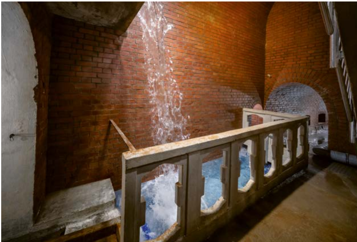
Wasserschloss im Norbertusheimstollen, Januar 2023, TWV-Fotoarchiv, Rolf Nachbar
