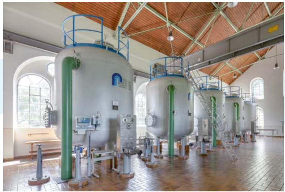
Aktivkohlekessel im Wasserwerk Zell, Januar 2023, TWV-Fotoarchiv, Rolf Nachbar
