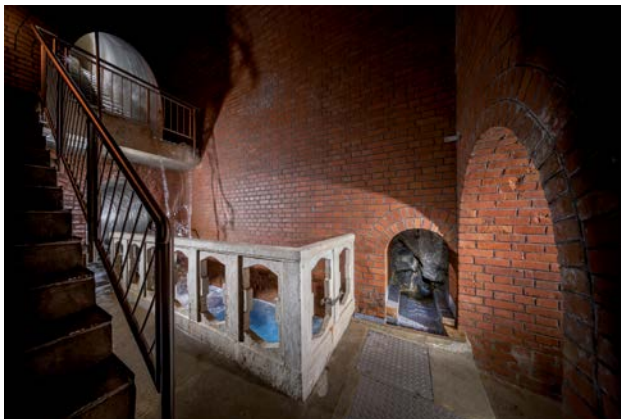
Wasserschloss im Norbertusheimstollen, Foto: Rolf Nachbar
