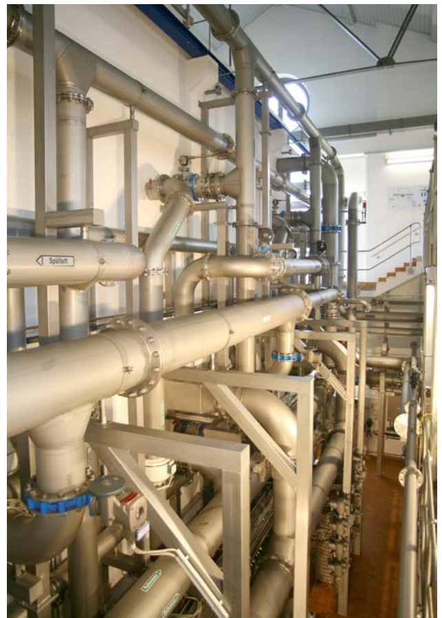
Bodenfiltrataufbereitung im Wasserwerk Mergentheimer Straße
