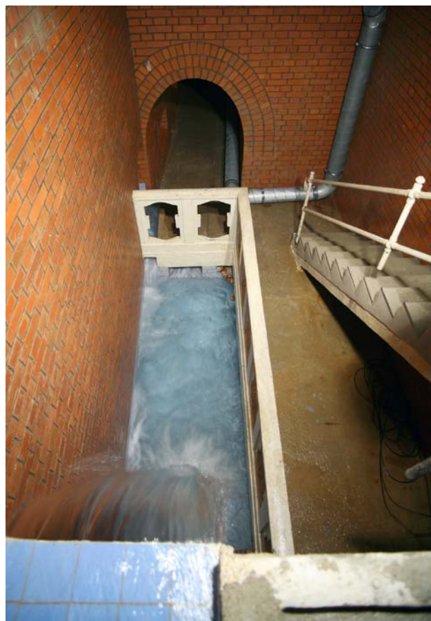
Wasserschloss im Norbertusheimstollen
