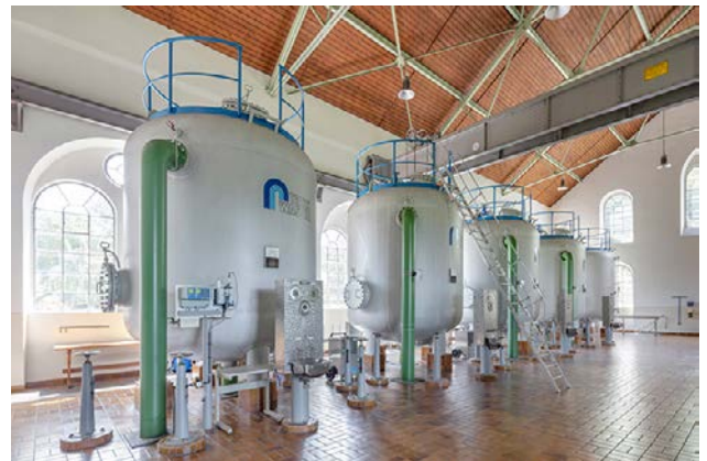
Aktivkohlefilter im Wasserwerk Zell, Foto: Gerhard Hagen
