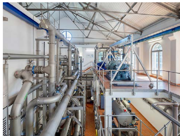
Bodenfiltrataufbereitung im Wasserwerk Mergentheimer Straße
