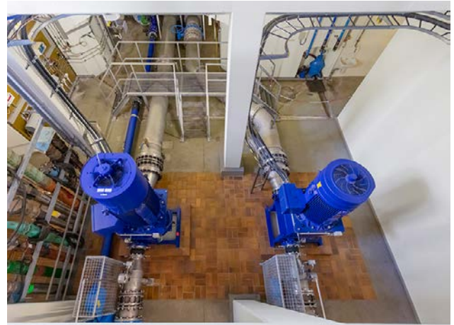
Netzwasserpumpen im Wasserwerk Zell, Foto: Gerhard Hagen
