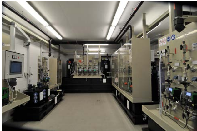
Dosieranlagenraum im Wasserwerk Bahnhofstraße
