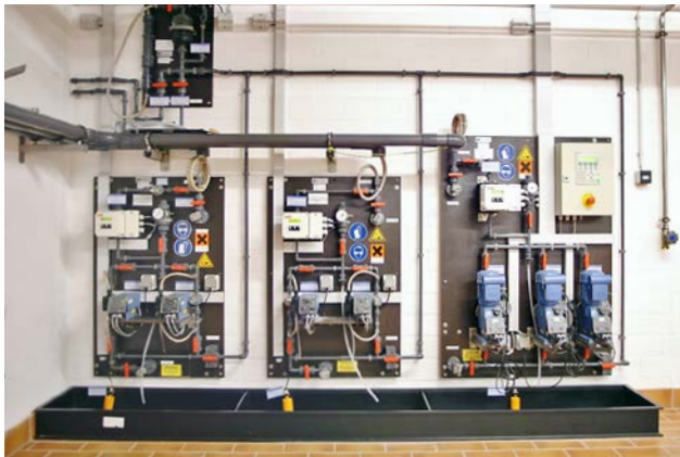
Flockungsmitteldosieranlage im Wasserwerk Mergentheimer Straße
