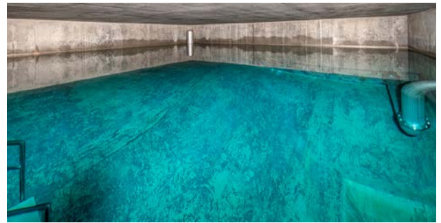
Reinwasserkammer im Wasserwerk Mergentheimer Straße, Foto: Gerhard Hagen
