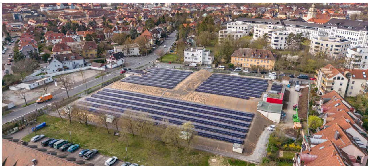
PV-Anlage HB Galgenberg, Foto: Rolf Nachbar
