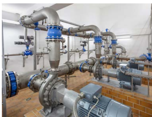
Innenansicht des Pumpwerkes Lengfeld
