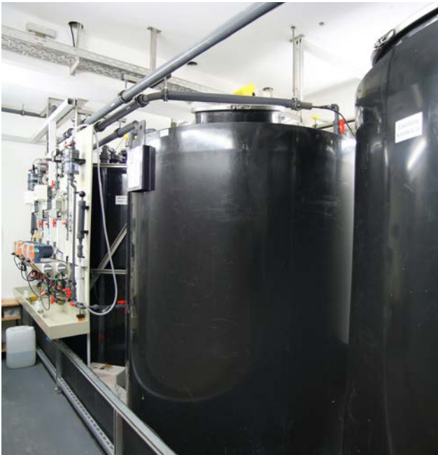
Lagertanks für Silikat und Phosphat im Hochbehälter Heiligenholz
