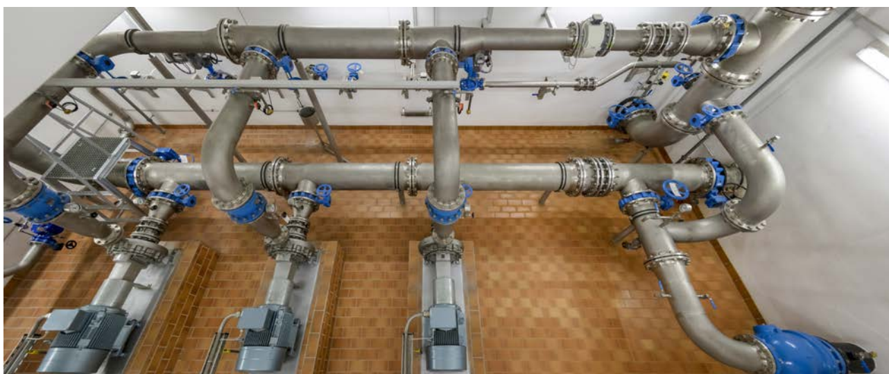
Innenansicht des Pumpwerkes Lengfeld
