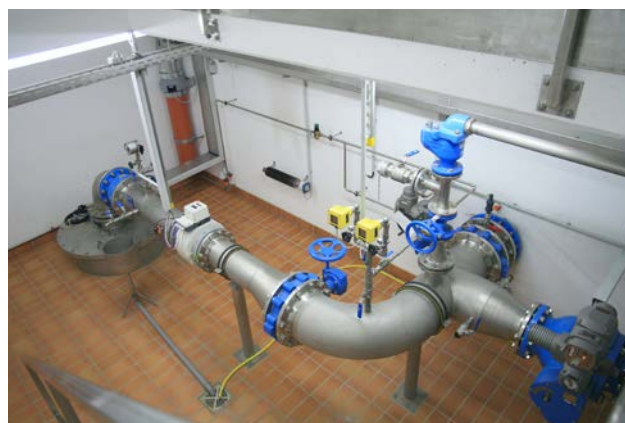
Brunnenkopf mit Rohrleitungen des Brunnens 2
