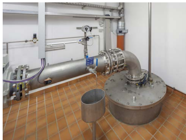
Brunnenkopf des Brunnens 1
