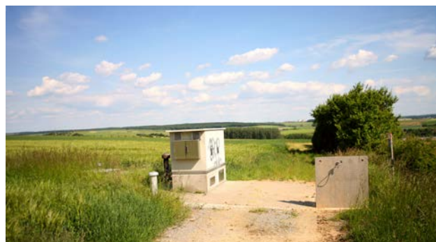
Außenansicht des Schachtes B 19 mit Kabelverteilerschrank
