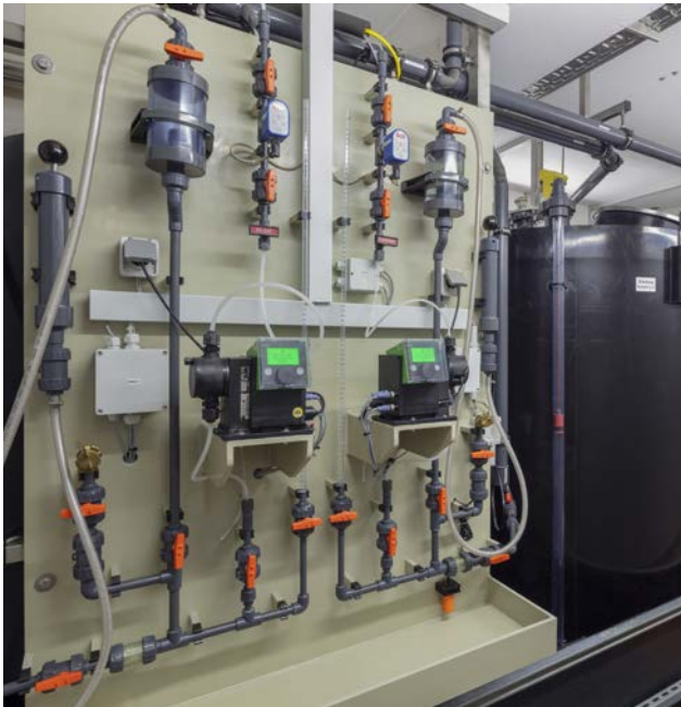
Dosieranlagenraum im Hochbehälter Heiligenholz
