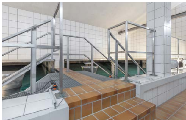
Wasserkammern im Hochbehälter Heiligenholz
