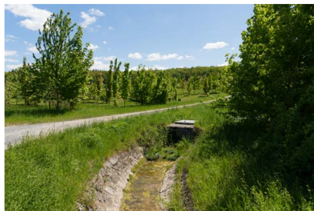
Auslaufbauwerk des Brunnens 1
