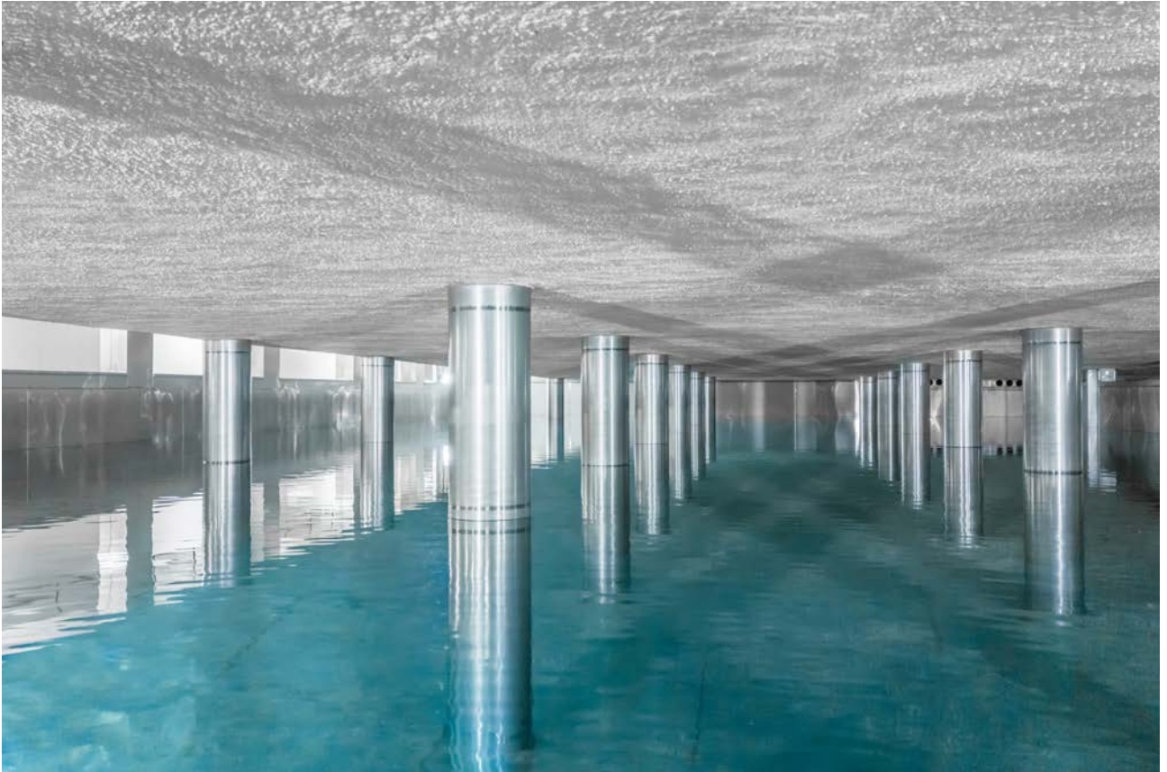
Kammer im Hochbehälter Galgenberg, Foto: Rolf Nachbar
