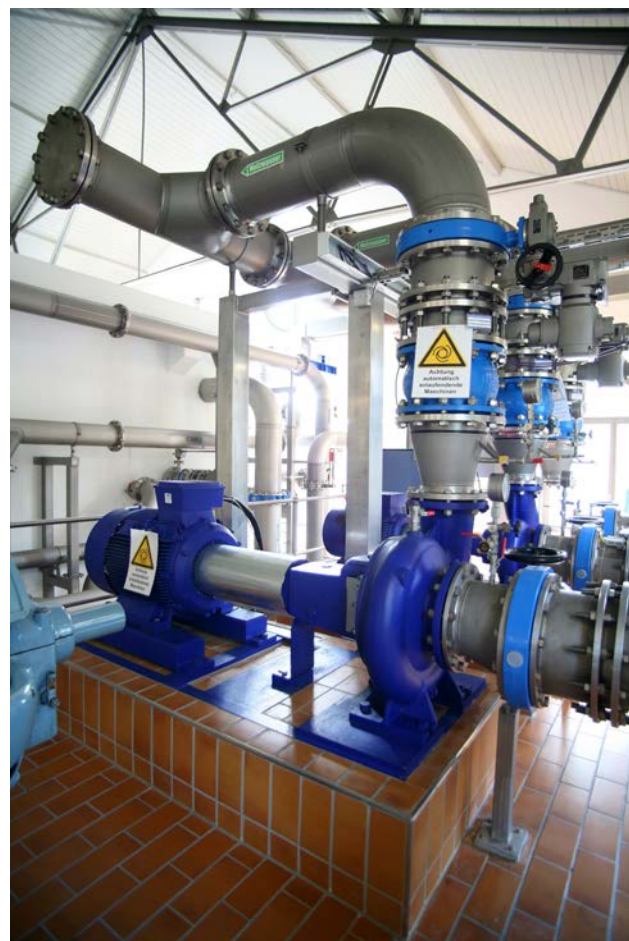
Pumpwerk Heidingsfeld im Wasserwerk Mergentheimer Straße
