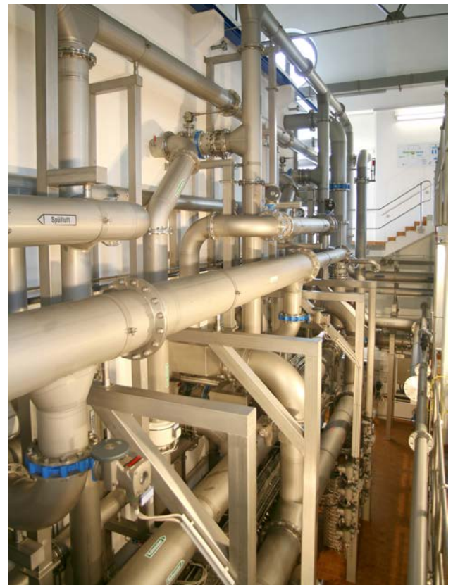
Bodenfiltrataufbereitung im Wasserwerk Mergentheimer Straße
