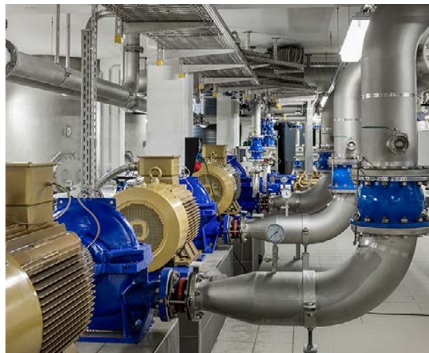
Netzwasserpumpwerk im Wasserwerk Bahnhofstraße, Foto: Gerhard Hagen
