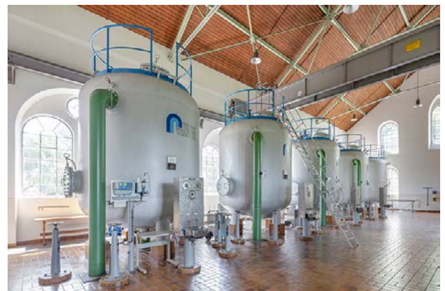
Aktivkohlefilter im Wasserwerk Zell, Foto: Gerhard Hagen
