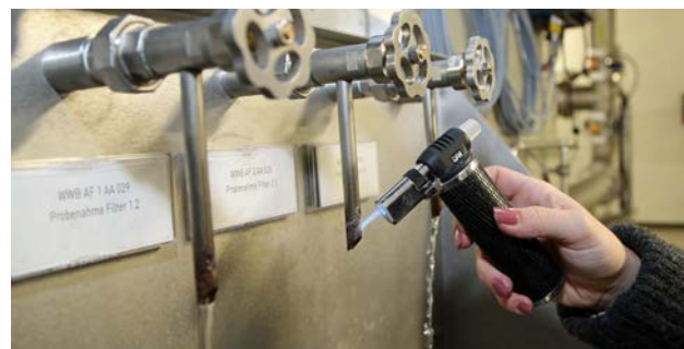
Abflammen einer Probenahmestelle
