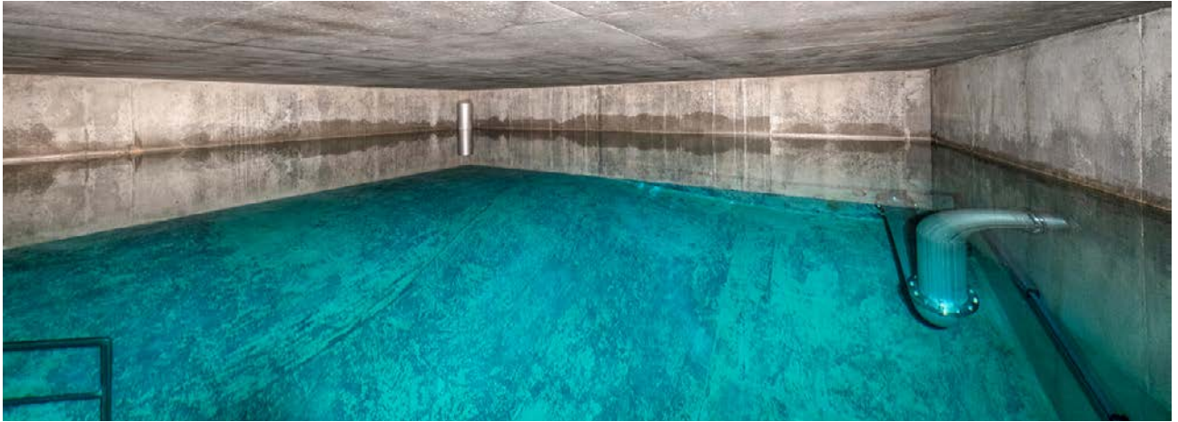
Reinwasserkammer im Wasserwerk Mergentheimer Straße, Foto: Gerhard Hagen
