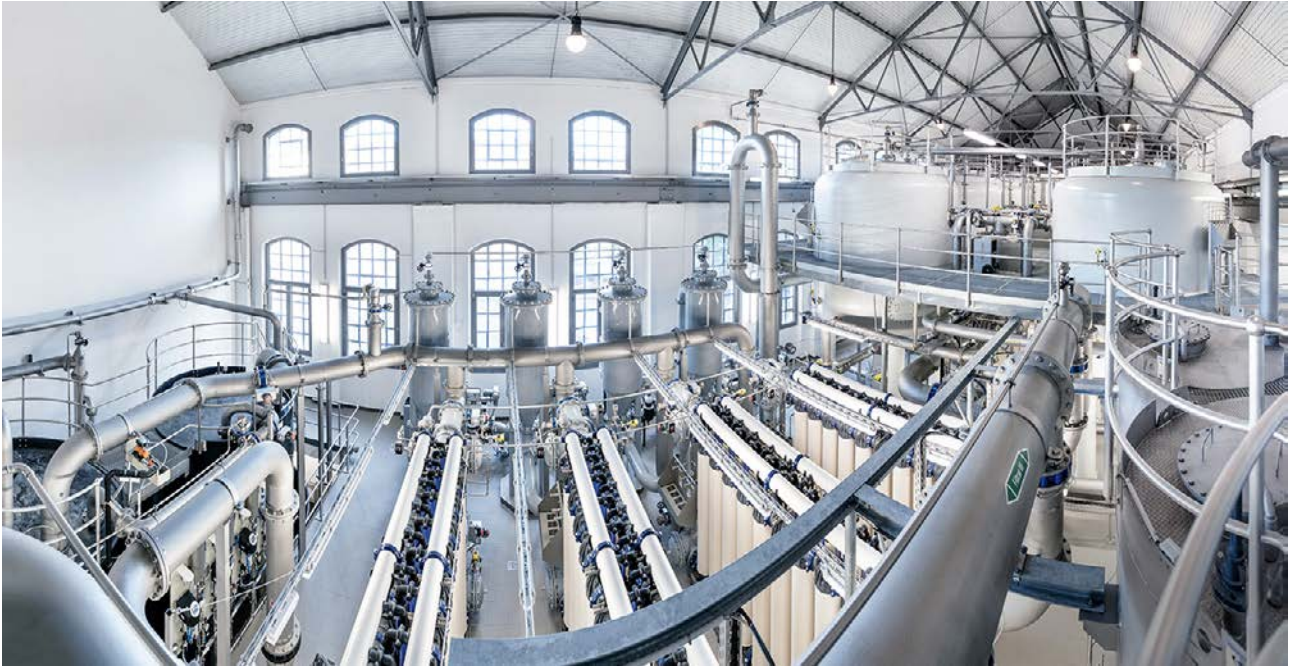
Ultra- und Aktivkohlefiltration im Wasserwerk Bahnhofstraße, Foto: Gerhard Hagen
