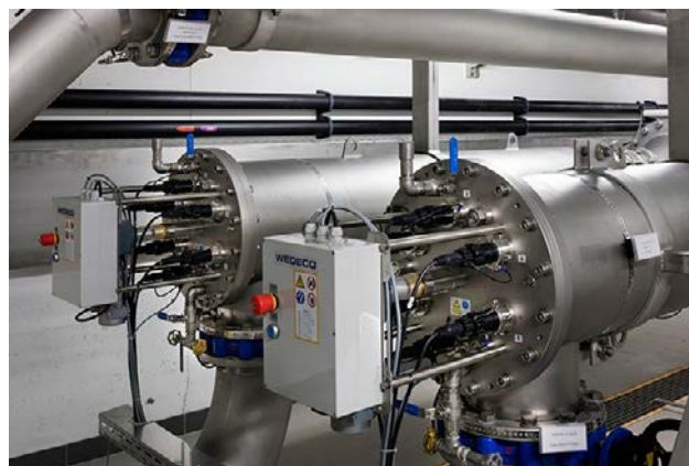
UV-Anlage im Wasserwerk Bahnhofstraße
