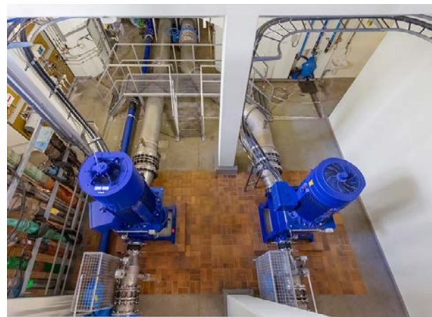
Netzwasserpumpen im Wasserwerk Zell, Foto: Gerhard Hagen
