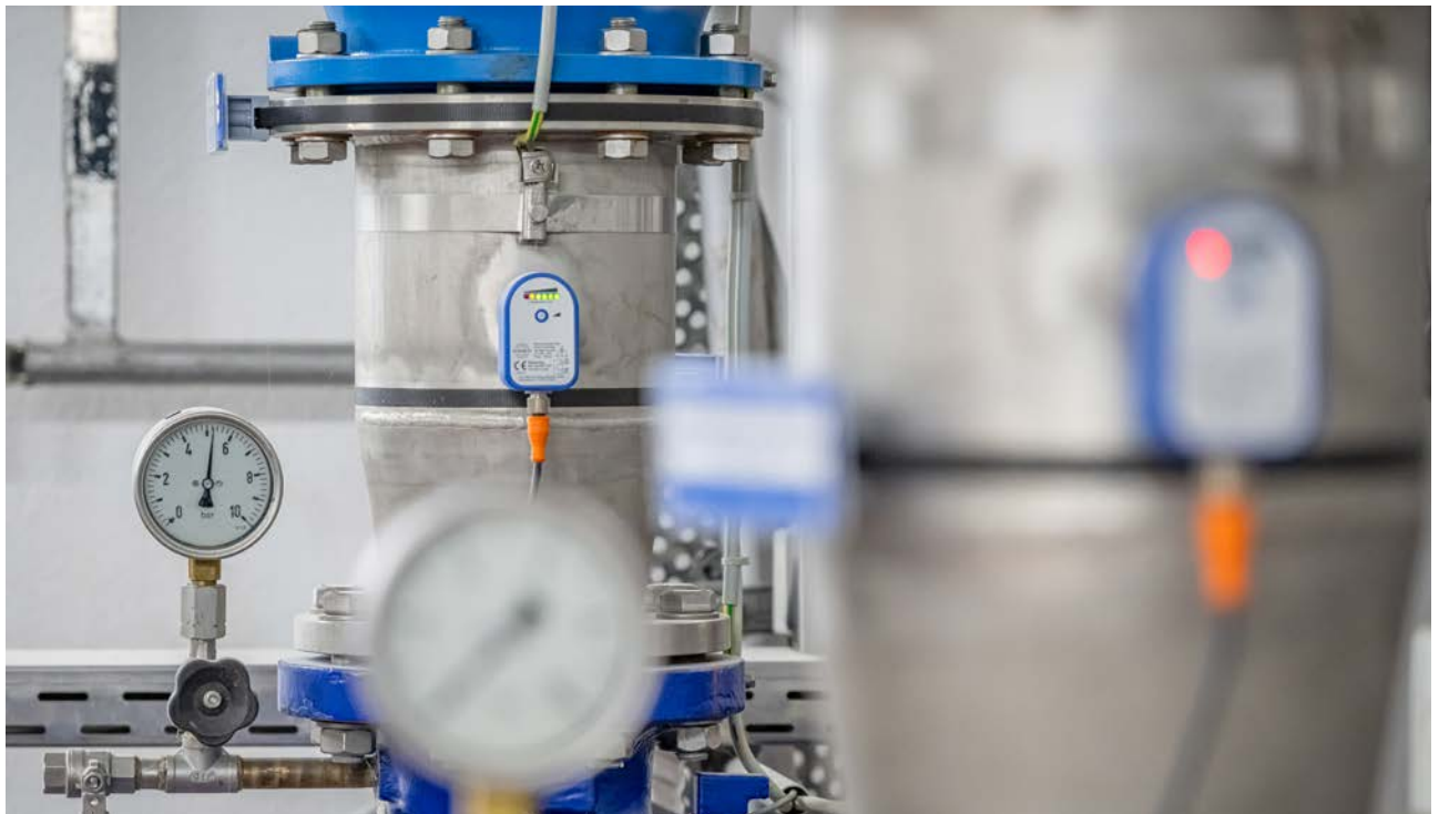
Manometer im Pumpwerk Hubland, Foto: Rolf Nachbar
