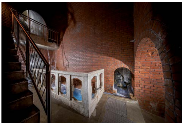
Wasserschloss im Norbertusheimstollen, Foto: Rolf Nachbar
