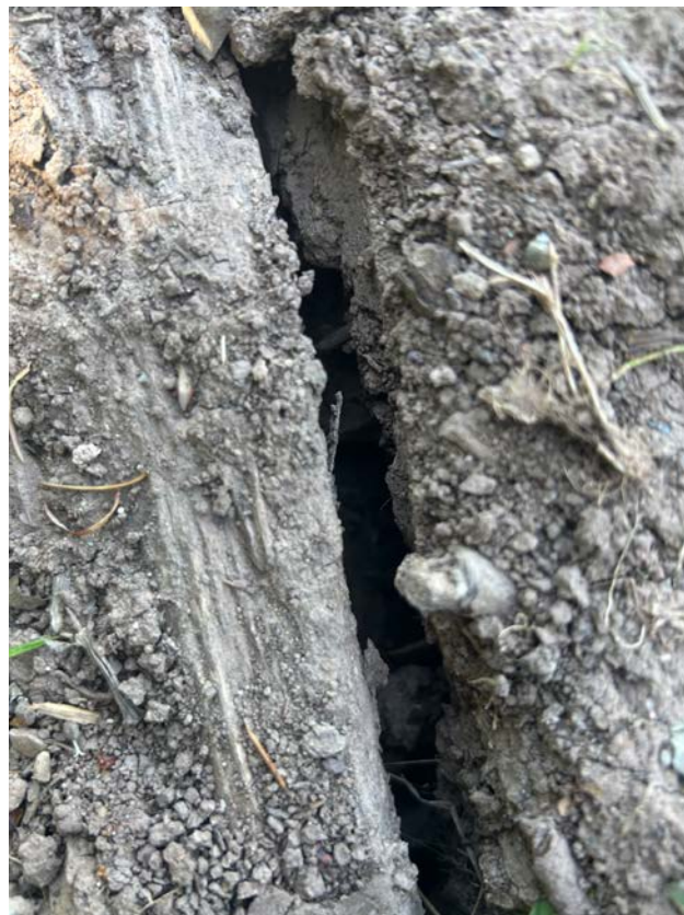
Trockenriss im Wasserschutzgebiet
