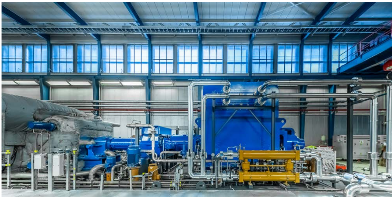
Neue Dampfturbine TS IV
