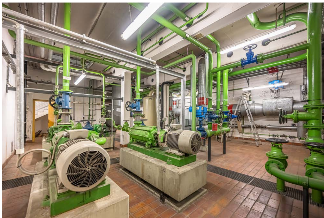
Pumpenanlage im Heizwerk Sanderau
