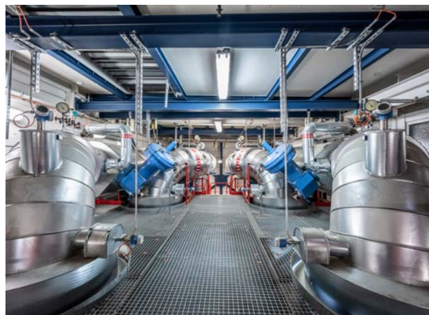
Umformstation (UFO) im Heizkraftwerk
