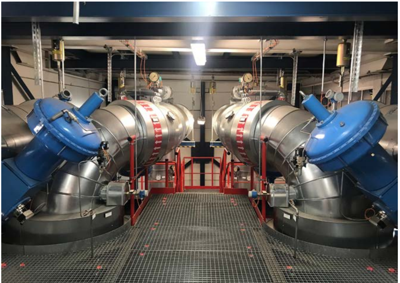
Umformstation (UFO) im Heizkraftwerk
