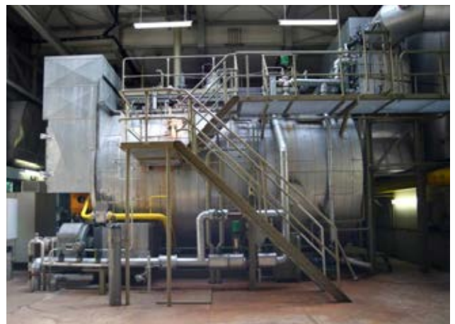
Kesselanlage Heizwerk Elferweg
