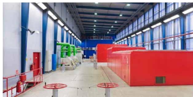
Turbinenanlagen im Heizkraftwerk
