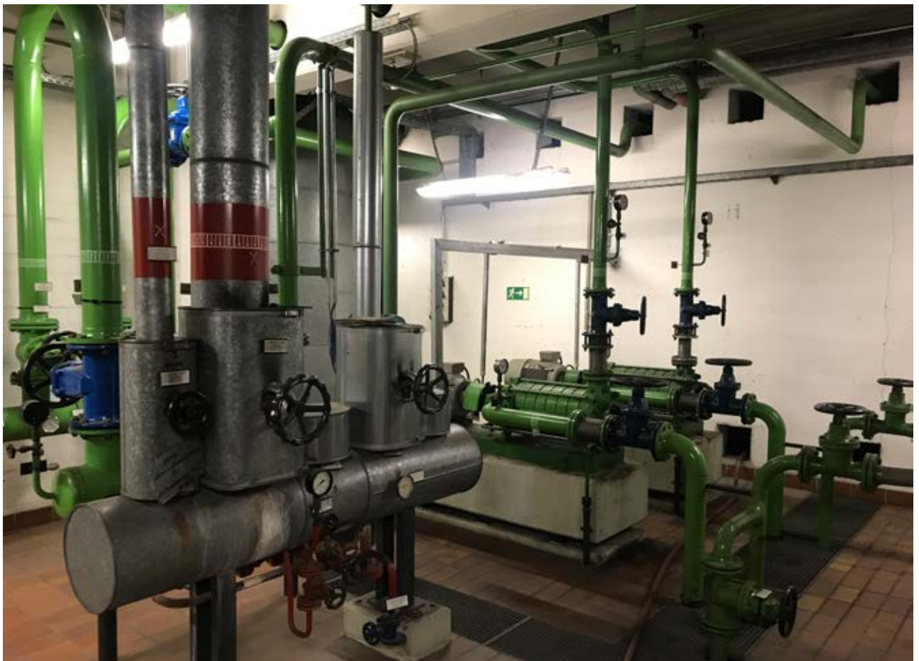
Pumpenanlage im Heizwerk Sanderau
