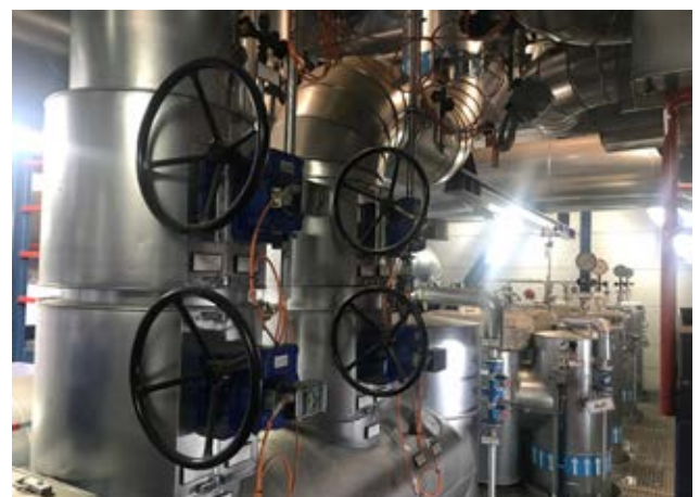
Umformstation (UFO) im Heizkraftwerk
