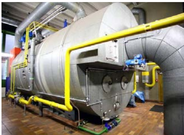
Kesselanlage Heizwerk Sanderau
