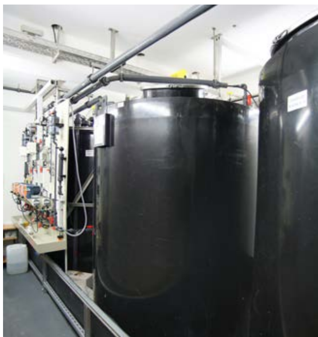
Lagertanks für Silikat und Phosphat
