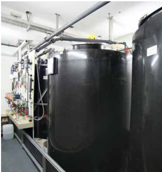
Lagertanks für Silikat und Phosphat
