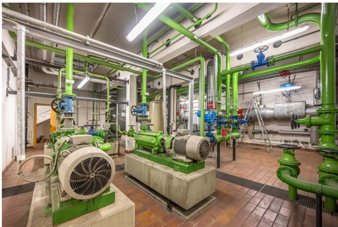
Pumpenanlage im Heizwerk Sanderau
