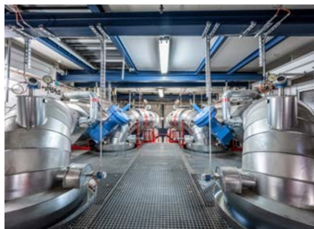
Umformstation (UFO) im Heizkraftwerk
