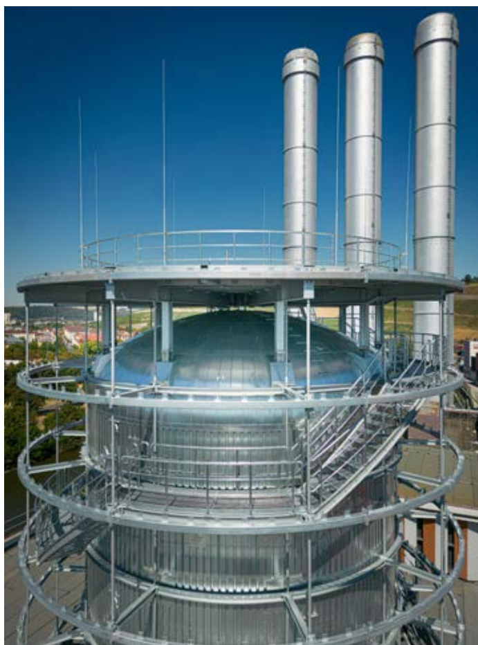
Wärmespeicher mit Kaminen
