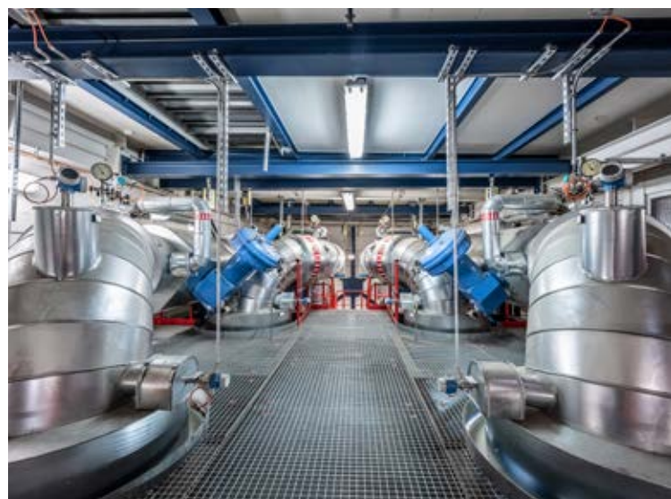
Umformstation (UFO) im Heizkraftwerk
