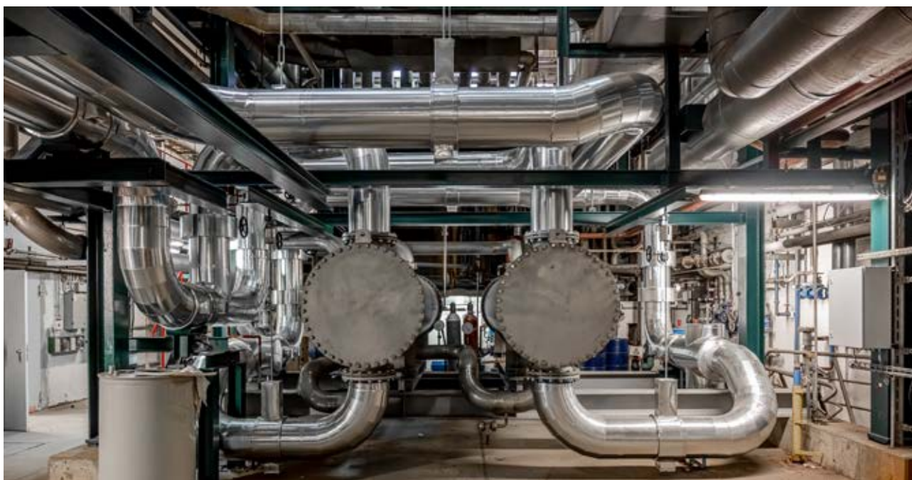
Neuer Sekundär-Kühlwasserkreislauf im Heizkraftwerk
