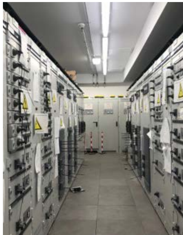
Neuer Schaltanlagenraum im Heizkraftwerk
