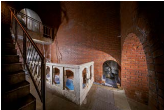
Wasserschloss im Norbertusheimstollen, Foto: Rolf Nachbar
