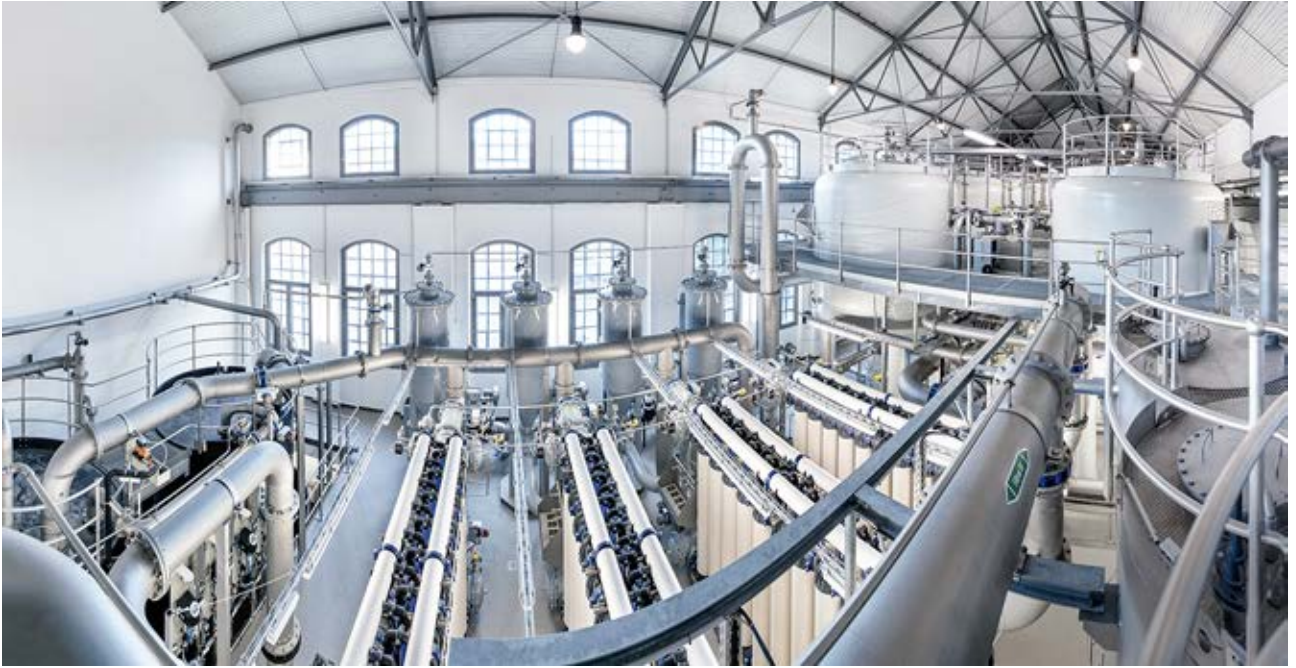
Wassserwerk Bahnhofstraße, Ultra- und Aktivkohlefiltration, Foto: Gerhard Hagen
