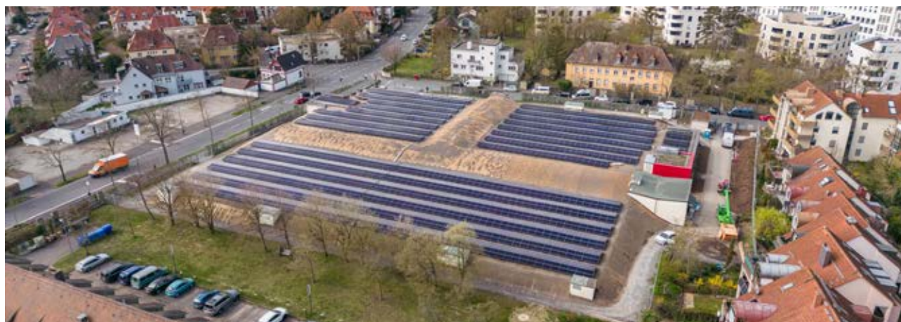
PV-Anlage HB Galgenberg, Foto: Rolf Nachbar
