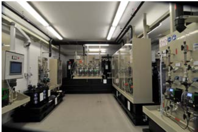
WW Bahnhofstraße, Dosieranlagenraum
