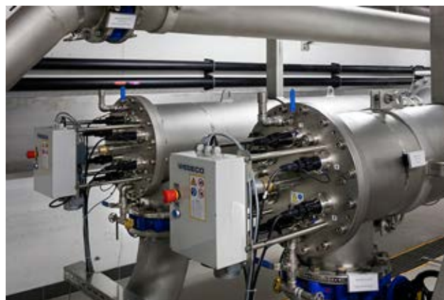
WW Bahnhofstraße, UV-Anlage
