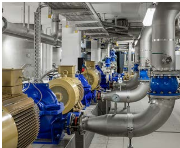
Netzwasserpumpwerk im Wassserwerk Bahnhofstraße, Foto: Gerhard Hagen
