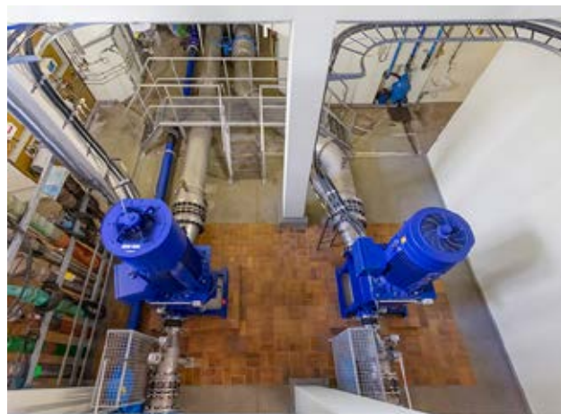
WW Zell, Netzwasserpumpen, Foto: Gerhard Hagen
