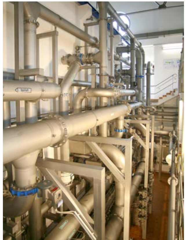
Bodenfiltrataufbereitung im Wasserwerk Mergentheimer Straße
