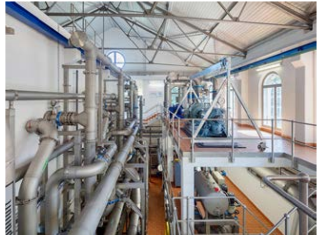
WW Mergentheimer Straße, Bodenfiltrataufbereitung
