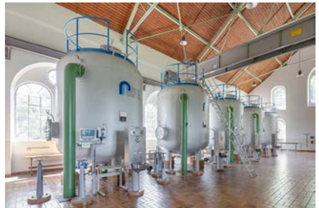
Aktivkohlefilter im Wasserwerk Zell, Foto: Gerhard Hagen
