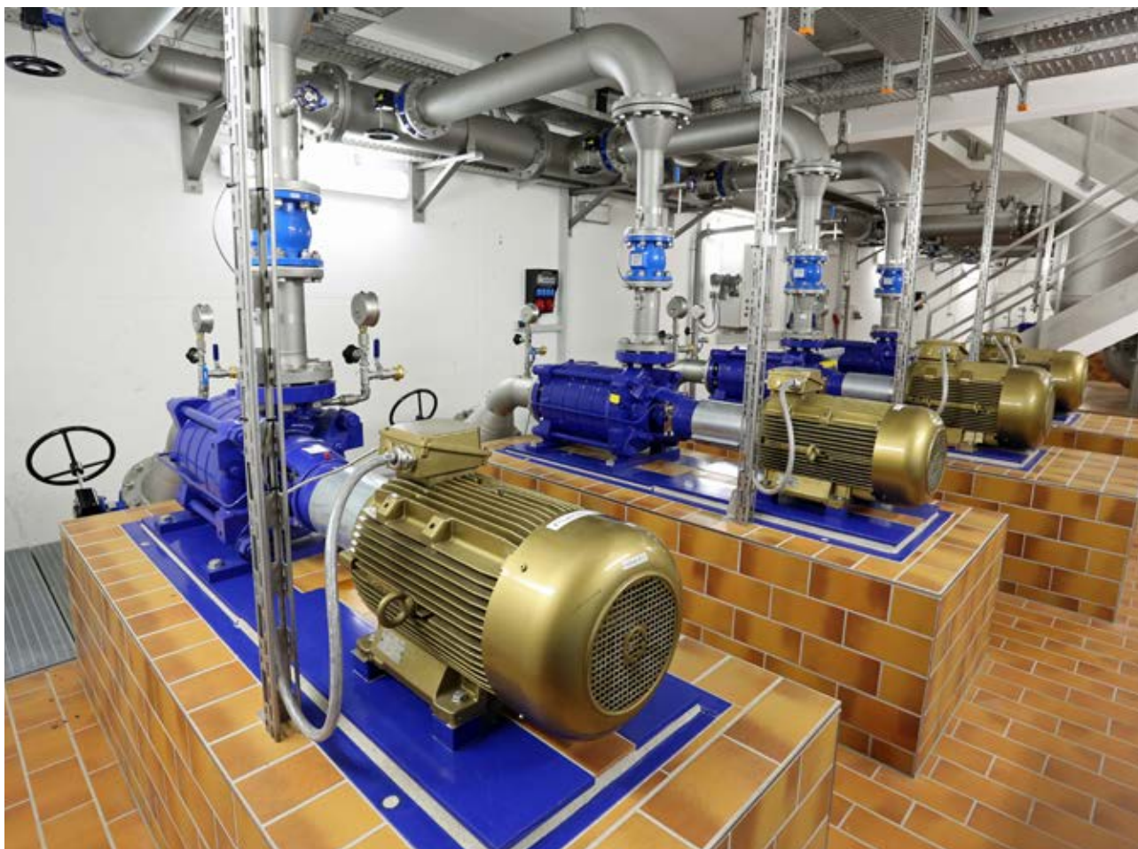
PW Hubland, Förderpumpen, Foto: Gerhard Hagen
