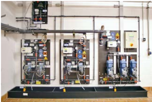
WW Mergentheimer Straße, Dosieranlage Flockungsmittel
