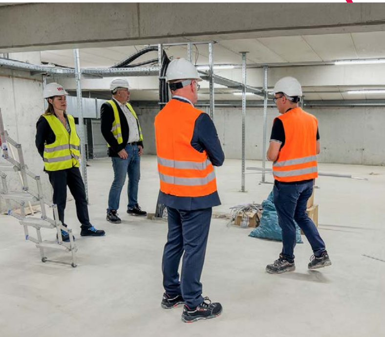
Besichtigung der Innenräume im Neubau des Umspannwerks Dürrbachau mit der Geschäftsführung im Sommer 2025.
